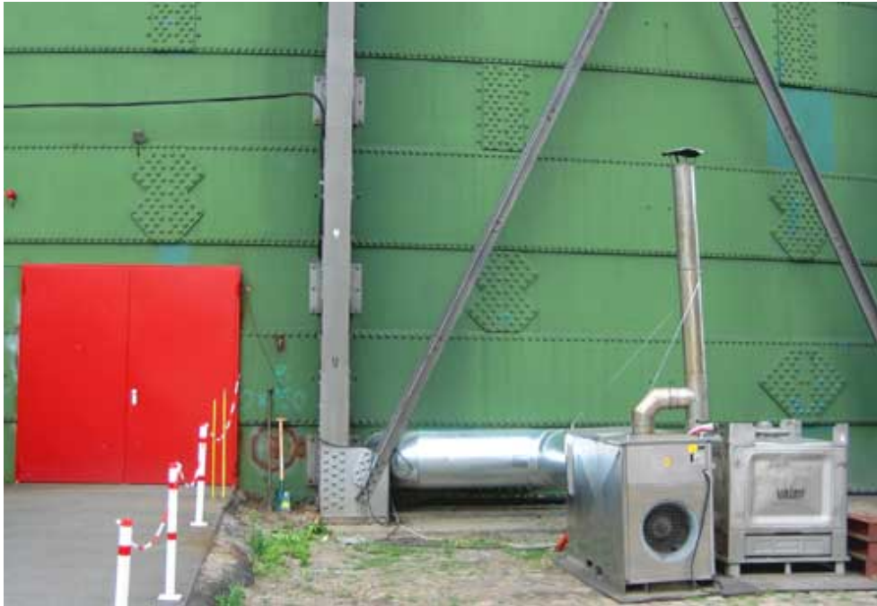
Feuerrote tür und Heizanlage am Gasometer Foto: Christiane Rodewaldt
